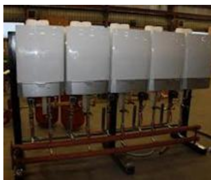
Foto 1: De cascade opstelling was overgedimensioneerd, ondanks besparingsvooruitzichten.
